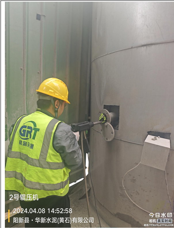
2#水泥磨辊压机排气筒采样口◎7
