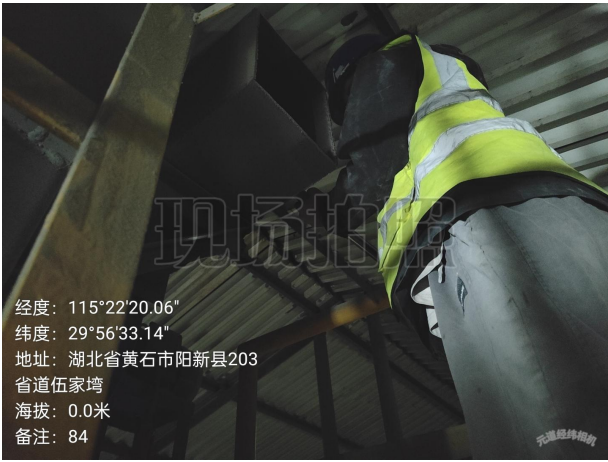
水泥库底输送 2DA084 有组织排放废气检测点位
