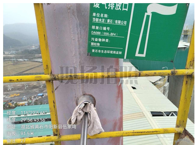
水泥库顶 4DA027 有组织排放废气检测点位
