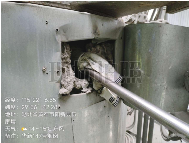
1#水泥磨球磨机排放口 DA147 有组织排放废气检测点位
