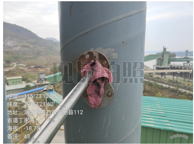
码头 2#泊位原煤进厂输送皮带 DA043 有组织排放废气检测点位
