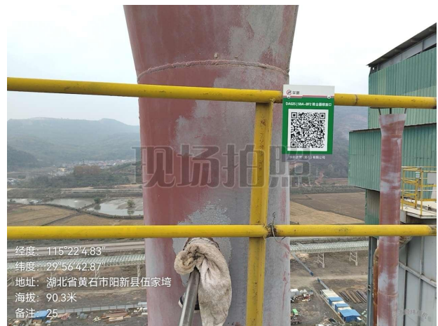
水泥库顶 2DA025 有组织排放废气检测点位
