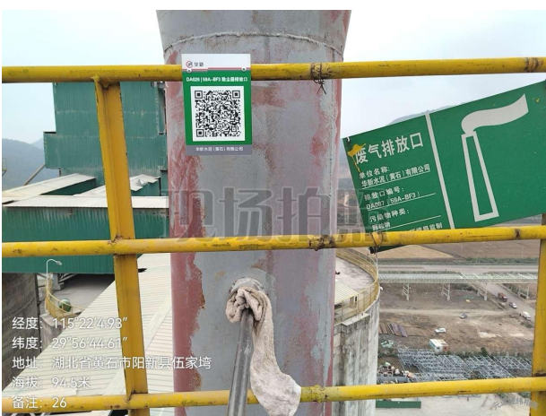
水泥库顶 3DA026 有组织排放废气检测点位
