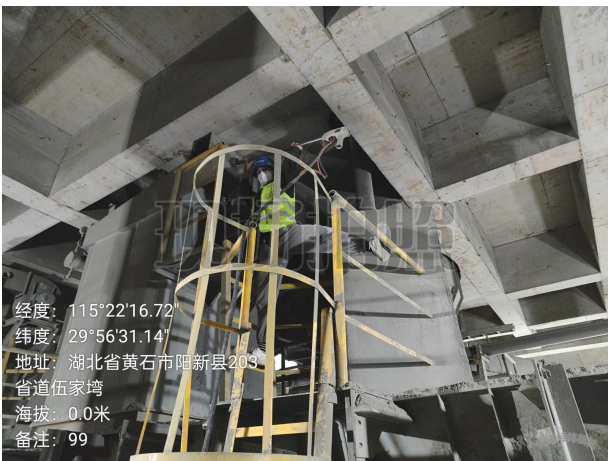
水泥库底 1 输送 DA099 有组织排放废气检测点位
